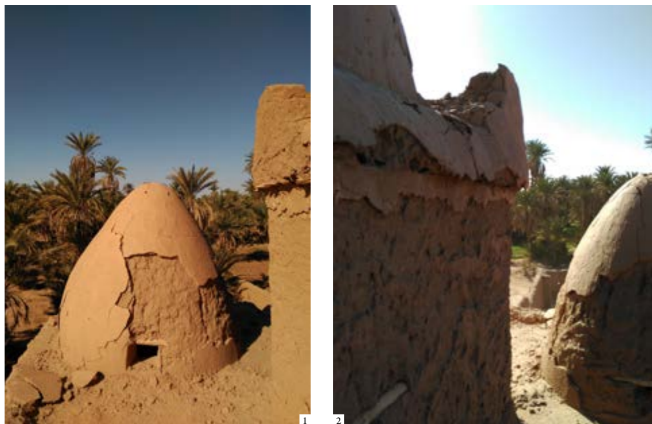
Condition of the exterior of the domes and the roof before restoration | Estado del exterior de las cúpulas y la cubierta antes de la restauración | Estado do exterior das cúpulas e a cobertura antes da restauração
