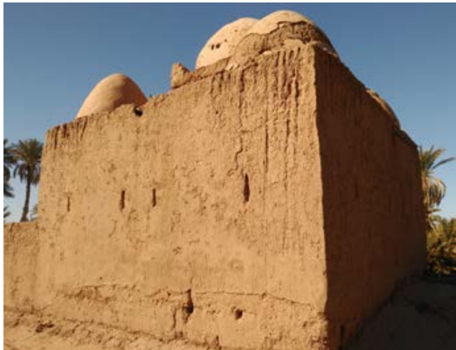
Northeast corner of the Marabout. Condition of the exterior finishings prior to the restoration | Esquina noreste del Morabito. Daños en acabados exteriores previos a la intervención | Esquina noroeste do marabu. Danos nas fachadas exteriores antes da intervenção
