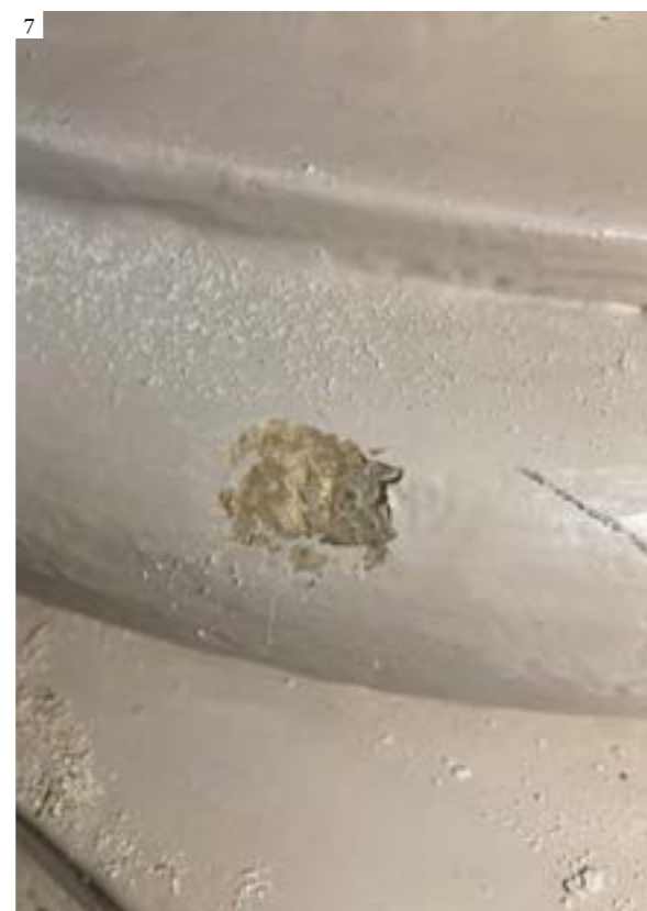
Figura 7: Restos de estuco ocre en el bocel de la base de una columna
