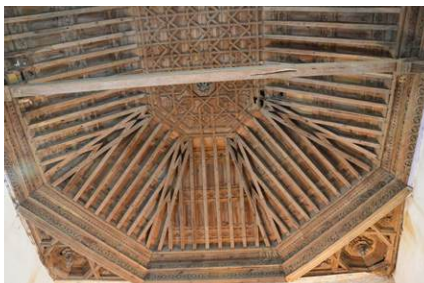
Chamfered end of the structure with missing, broken, and detached pieces | Detalle de la cabecera ochavada de la armadura, con pérdidas, roturas y desplazamiento de maderas | Pormenor da treliça oitavada, com perdas, rupturas e deslocação de madeiras
