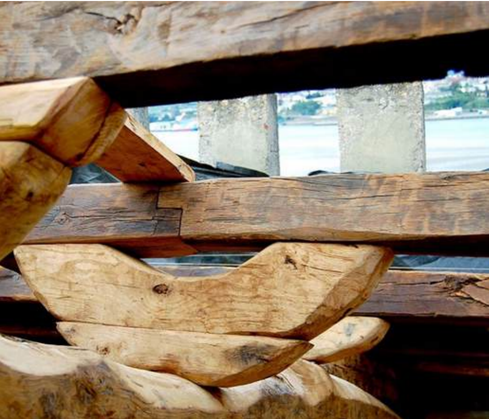
Footing solution for beams | Solución de zapata de cubierta | Solução de sapata
