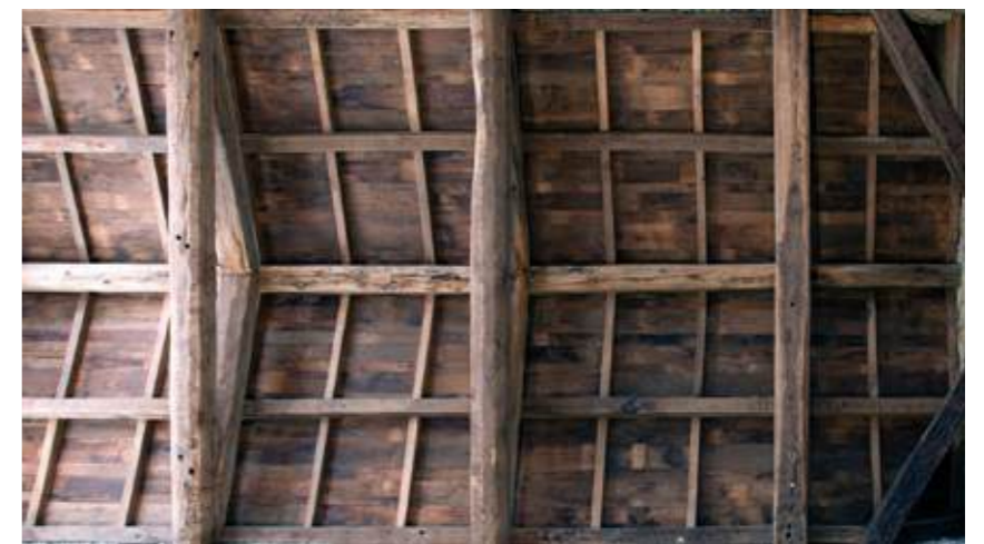
Roof structure over the central stairs | Armado de la cubierta de la escalera central | Estrutura da cobertura da escada central
