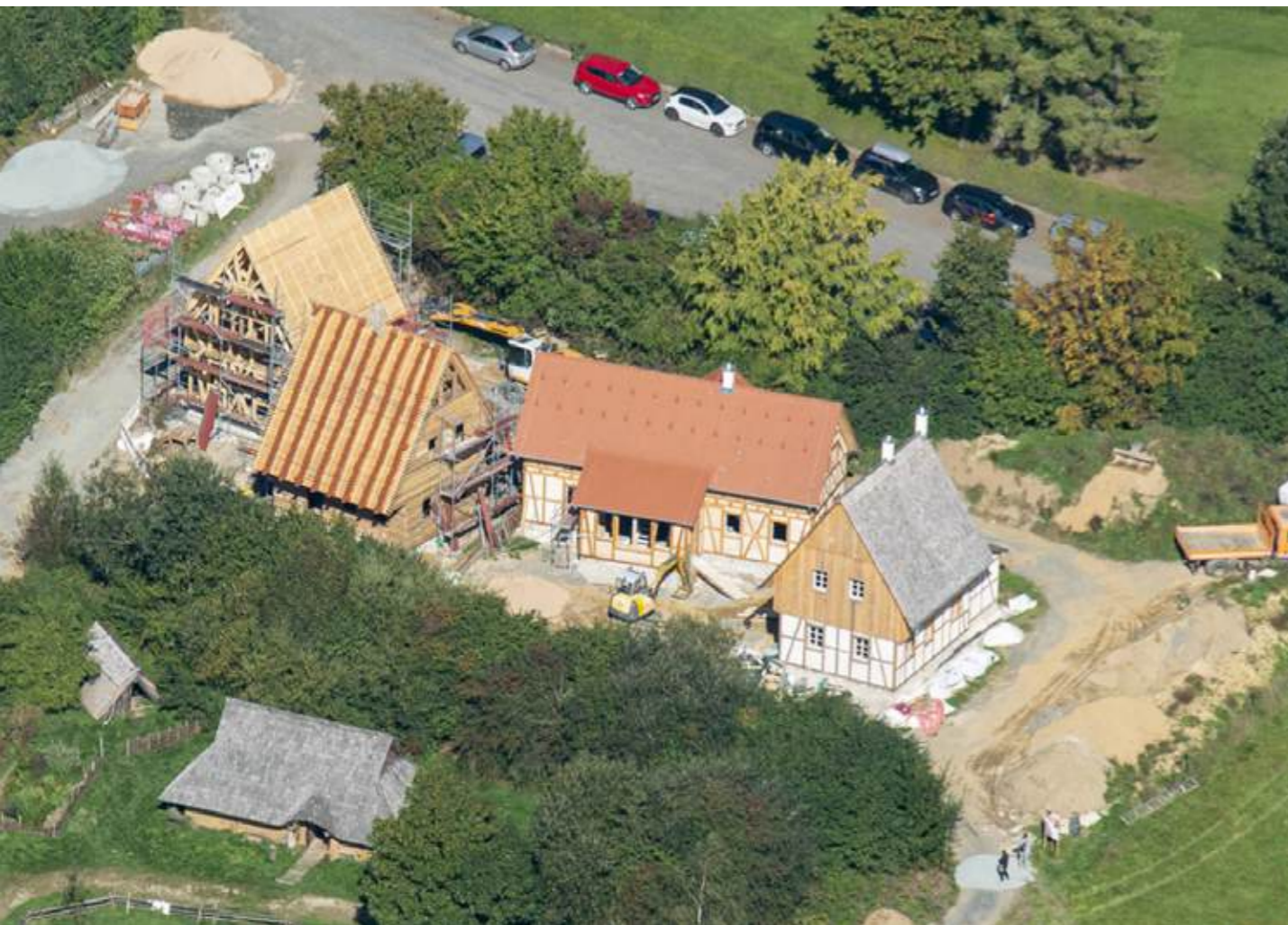
Construction site in autumn 2023 | Estado de las obras en el otoño de 2023 | Estaleiro de construção no Outono de 2023 (Geschichtspark Bärnau)
