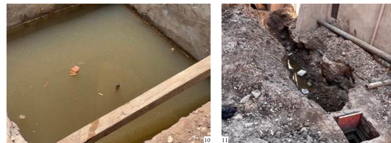
Figure 10: Groundwater in foundations | Agua subterránea en los cimientos | Água subterránea nas fundações
