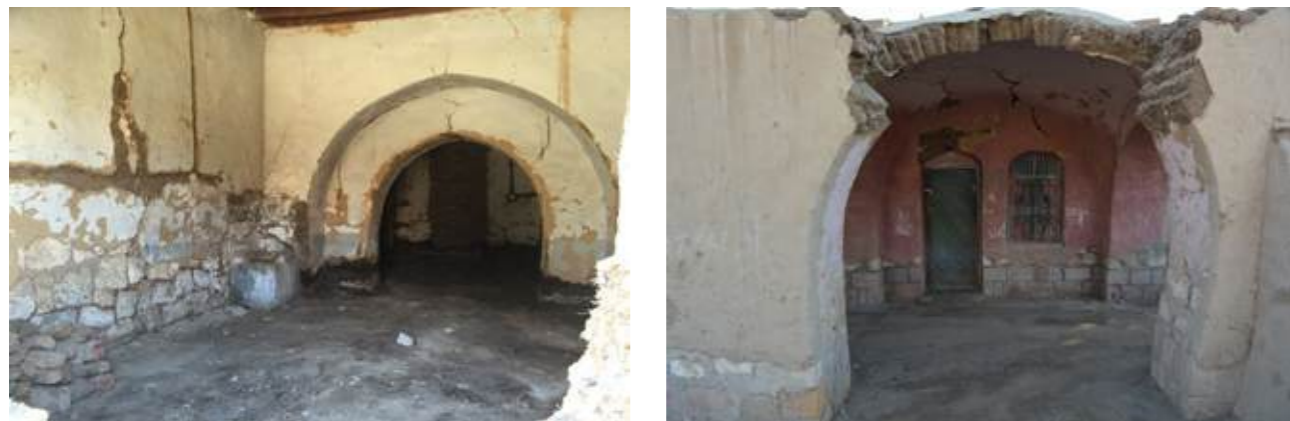
Figure 7: Lack of regular maintenance of New Gourna buildings | Falta de mantenimiento periódico de los edificios de Nueva Gourna | Falta de manutenção regular dos edifícios de Nova Gourna
