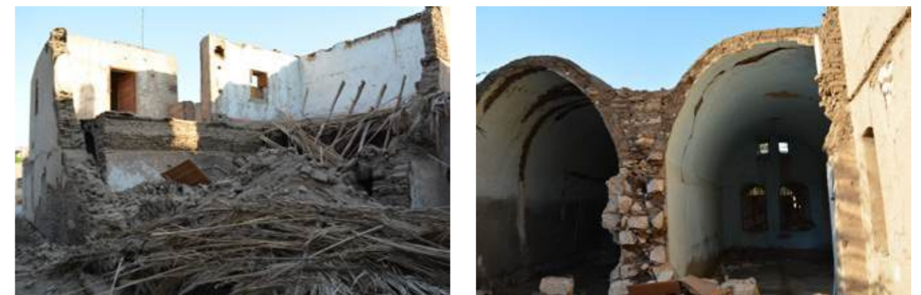
Figure 6: Deterioration and collapse of New Gourna buildings | Deterioro y derrumbe de los edificios de Nueva Gourna | Deterioração e colapso dos edifícios de Nova Gourna
