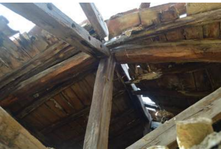
Figuras 19 y 20: Daños en la cubierta y en los muros
