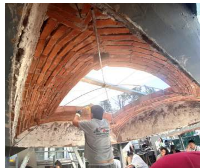
Figura 4. Bóveda extremeña, apoyada en arcos perimetrales, ejecutada por el maestro Máximo Portal
