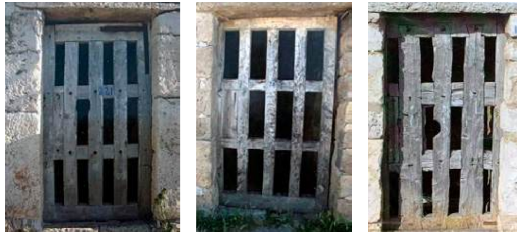
Figura 15: Algunas puertas de las Bodegas de Baltanás, con ejemplos de caja y espiga pasante y enclavada. De izquierda a derecha: travesaño vertical a media madera recta / travesaño vertical a caja y espiga / travesaño vertical con cola de milano (Ayuntamiento de Baltanás)
