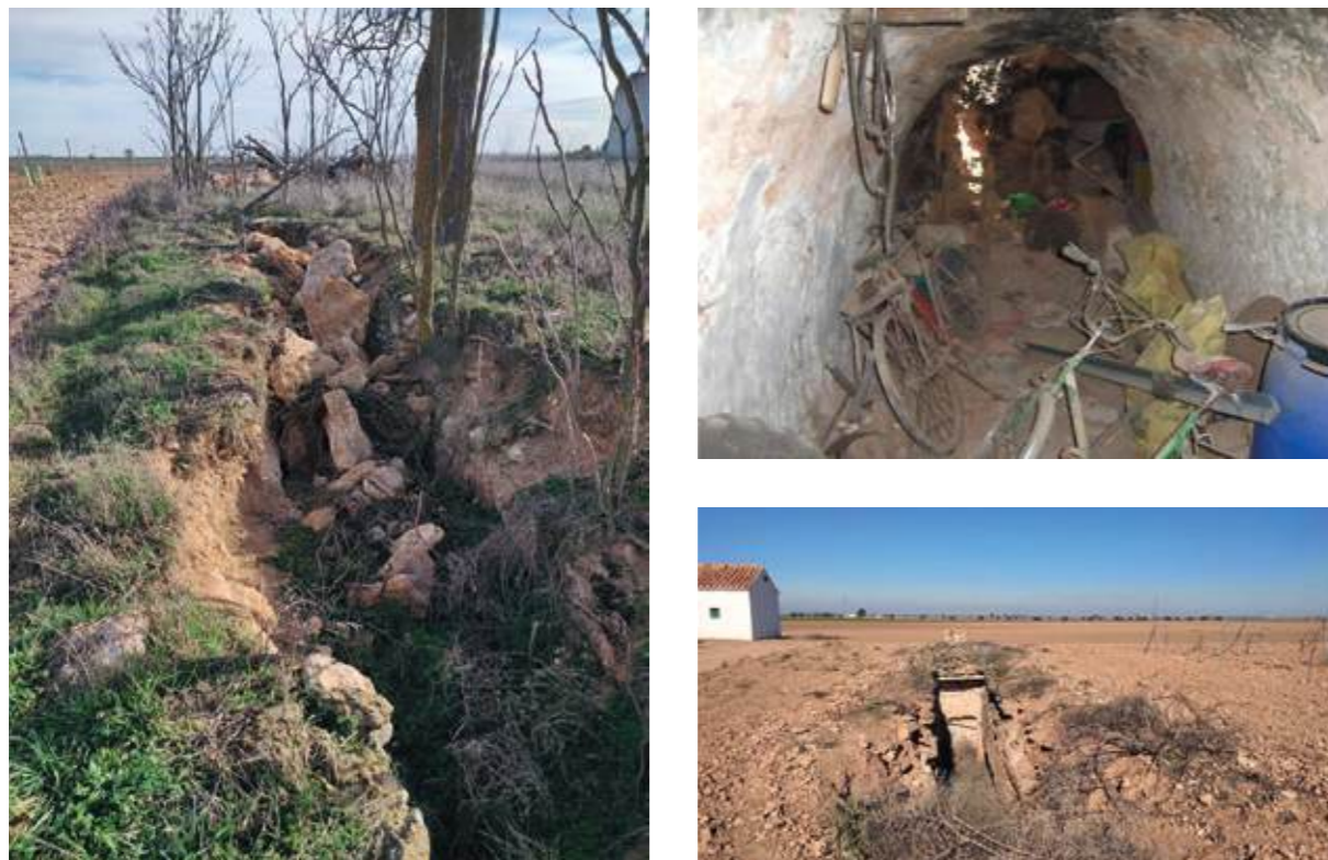
Figura 15: Estado de abandono y degradación de diversas cuevas de quintería. Cueva en el paraje de Limpiachimeneas (Daimiel), cueva en el paraje de Carrilejo y cueva en el paraje de Frailes (Manzanares) (David Cejudo, Iván Acosta e Iván Fernández-Espartero)
