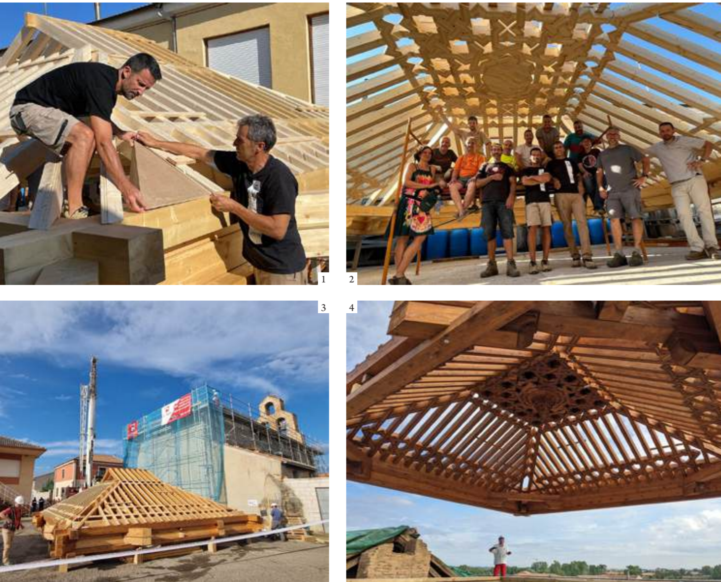
1: The new chancel ceiling structure assembled in the workshop. Detail of the traditional application of carpentry squares for marking cuts on structural pieces: rafters, collar ties, and hip beams 2: The roof structure with a group of pupils who took part in building it 3: The new chancel roof structure assembled on site prior to being lifted into place, 2023 4: The new chancel roof structure seen from below | 1: La nueva armadura de cubierta del presbiterio montada en el taller. Detalle de la aplicación tradicional de los cartabones de armadura para trazar los cortes de las piezas estructurales: pares, nudillos y limas 2: La armadura de cubierta junto a un grupo de alumnos que participaron en su construcción 3: La nueva armadura del presbiterio montada a pie de obra antes de ser elevada, 2023 4: Vista inferior de la nueva armadura del presbiterio | 1: A nova estrutura do tecto do presbitério montada na oficina. Pormenor da aplicação tradicional dos quadrados de carpintaria para marcar os cortes das peças estruturais: caibros, vigas e espigões. 2: A estrutura da cobertura com um grupo de alunos que participaram na sua construção. 3: A nova estrutura do tecto do presbitério montada no local antes de ser levantada, 2023. 4: Vista inferior da nova estrutura da cobertura do presbitério
