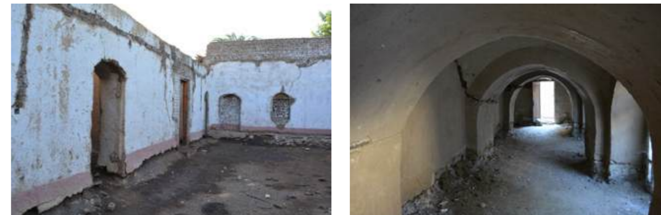
Figure 9: Erosion of foundations and walls due to groundwater seepage | Erosión de los cimientos y muros debido a la filtración de agua subterránea | Erosão das fundações e das paredes devido à infiltração de águas subterráneas
